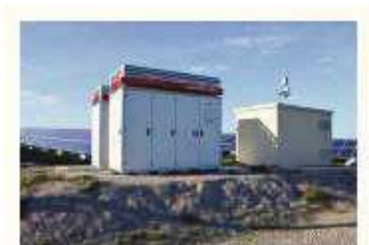
Photo 47 : Exemple d'onduleur Outdoor (source : QUADRAN)
